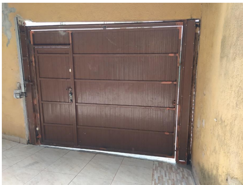
Figura 67: Descolamento junto ao muro de divisa entre os imóveis de nº 05 e nº 25 – 16 de dezembro de 2021.
