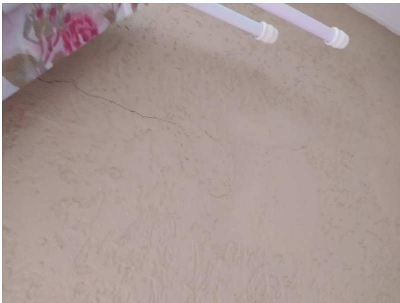
Figura 64: Trinca em parede do Imóvel nº 25 – 16 de dezembro de 2021.
