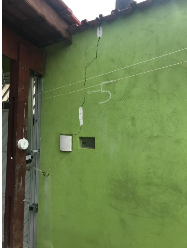
Figura 17: Trinca localizada no muro de fechamento do Imóvel nº 05 – próximo à entrada – 11 de outubro de 2021.
