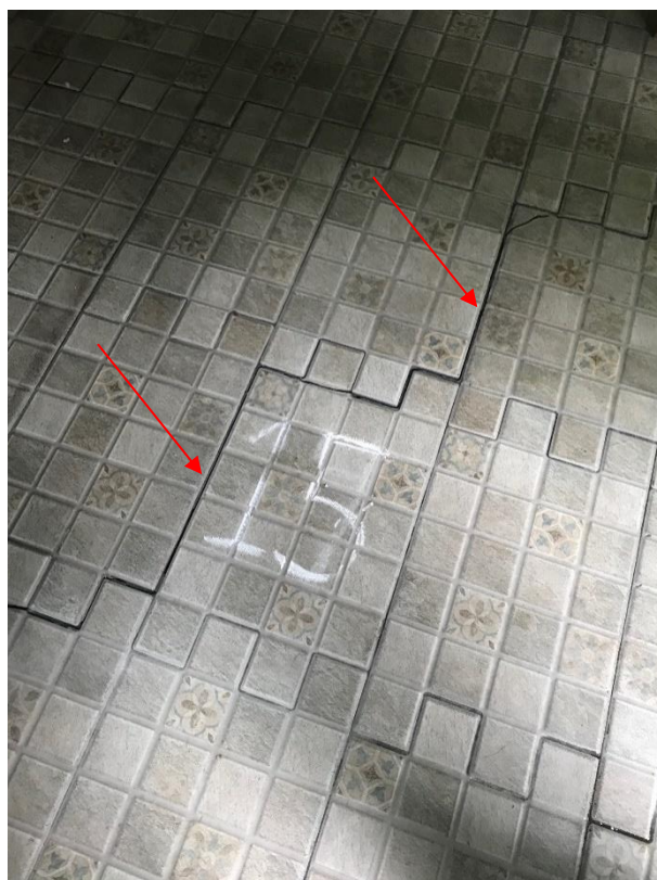
Figura 14: Trinca/Descolamento do piso na área do Imóvel nº 05 – 11 de outubro de 2021.
