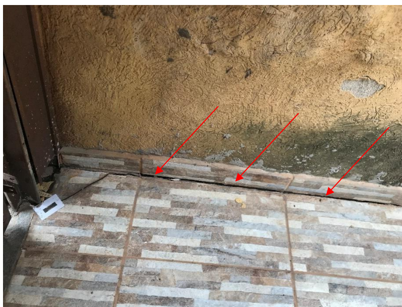
Figura 30: Trinca/Descolamento horizontal junto ao muro de divisa com o imóvel nº 25 – 25 de outubro de 2021.
