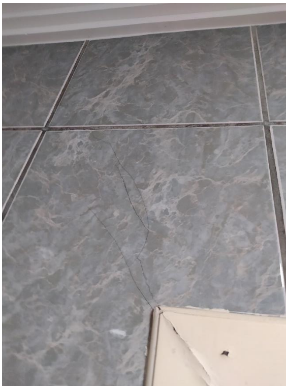
Figura 66: Trinca em parede do Imóvel nº 25 – 16 de dezembro de 2021.
