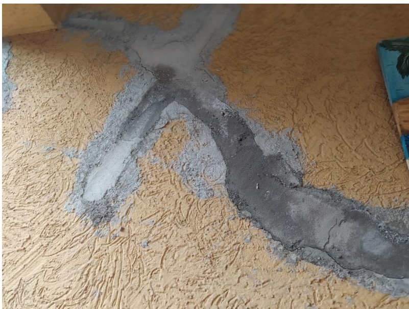
Figura 61: Reparos no imóvel nº 25 efetuados em períodos pretéritos – Decorrente de obras da Sabesp – 16 de dezembro de 2021.
