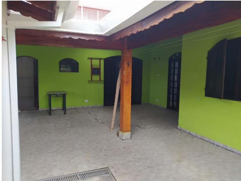
Figura 53: Trinca/Descolamento do piso na área do Imóvel nº 05 – 16 de dezembro de 2021.
