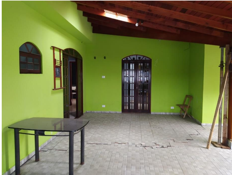
Figura 55: Trinca/Descolamento do piso na área do Imóvel nº 05 – 16 de dezembro de 2021.
