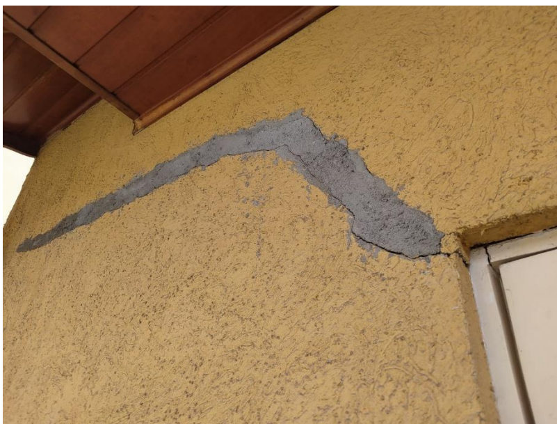
Figura 63: Reparos no imóvel nº 25 efetuados em períodos pretéritos – Decorrente de obras da Sabesp – 16 de dezembro de 2021.
