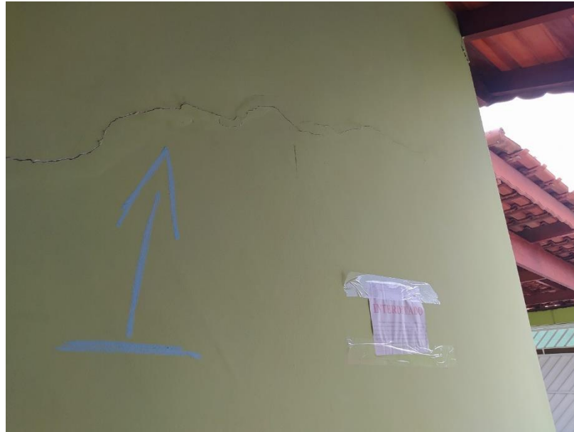
Figura 39: Trinca em parede do Imóvel nº 05 – 16 de dezembro de 2021.
