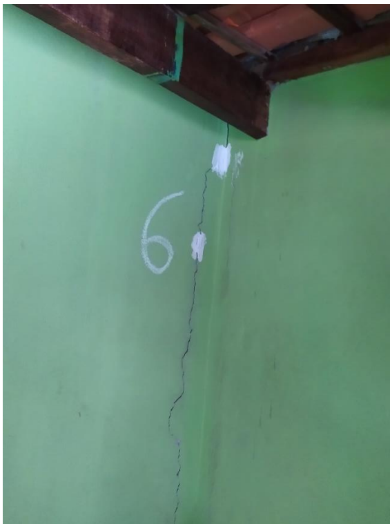
Figura 37: Trinca em parede do Imóvel nº 05 – 16 de dezembro de 2021.
