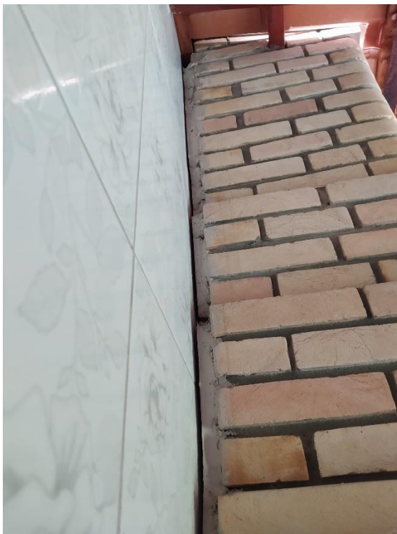
Figura 51: Trinca/Descolamento vertical junto ao muro de fechamento do imóvel nº 05 – 16 de dezembro de 2021.
