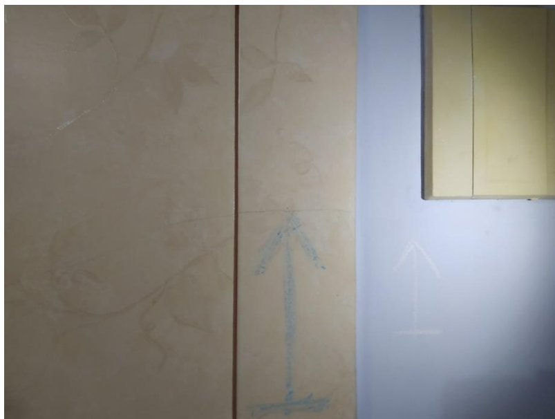
Figura 52: Trinca em parede do Imóvel nº 05 – 16 de dezembro de 2021.
