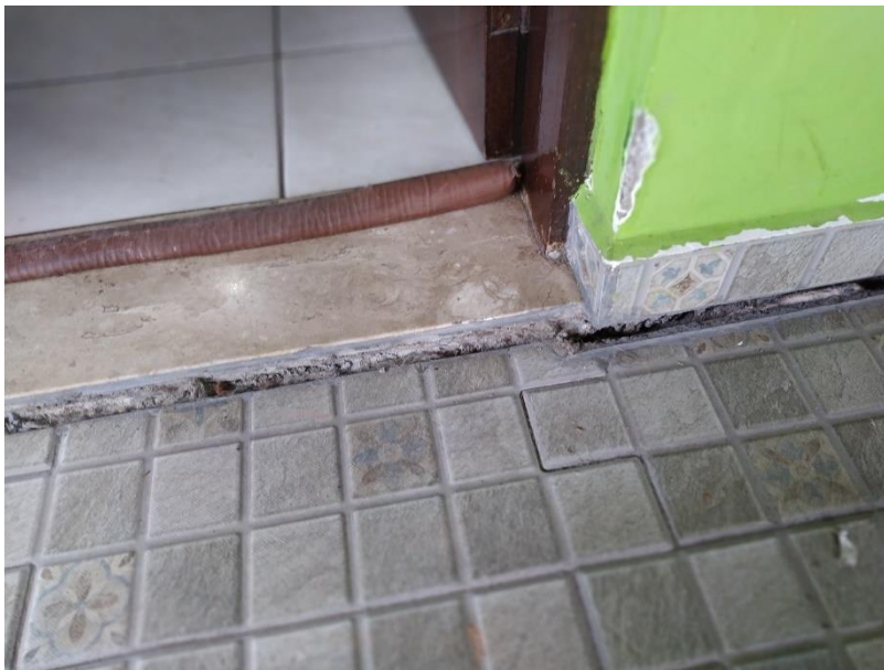
Figura 49: Trinca/Descolamento do piso na área do Imóvel nº 05 – 16 de dezembro de 2021.
