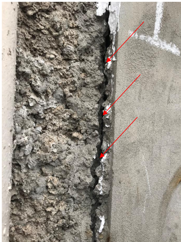
Figura 24: Trinca/Descolamento vertical junto ao muro de fechamento do imóvel nº 05 – 25 de outubro de 2021.
