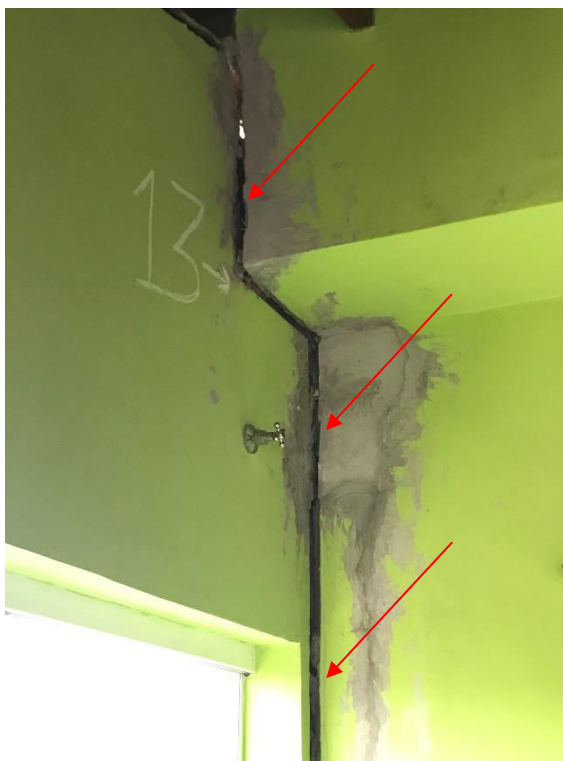
Figura 29: Trinca/Descolamento vertical junto ao muro de fechamento do imóvel nº 05 – 25 de outubro de 2021.
