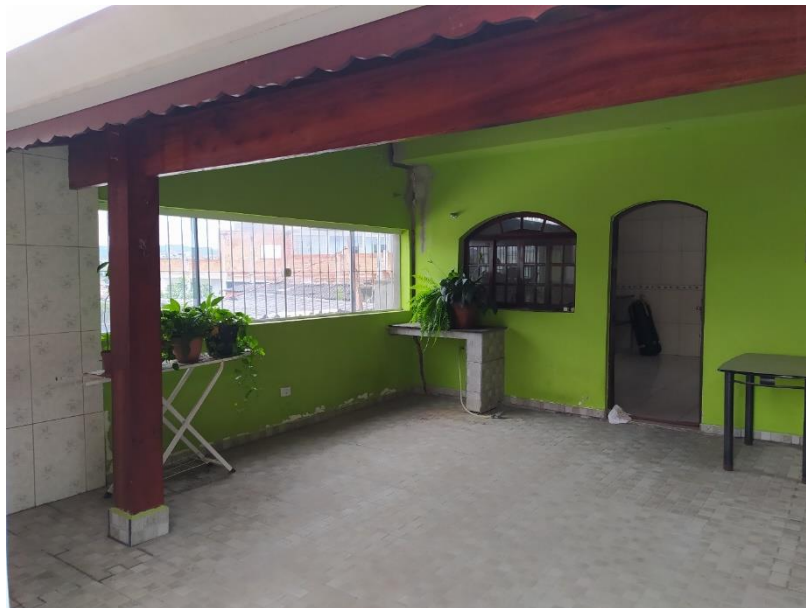
Figura 54: Trinca/Descolamento na área do Imóvel nº 05 – 16 de dezembro de 2021.
