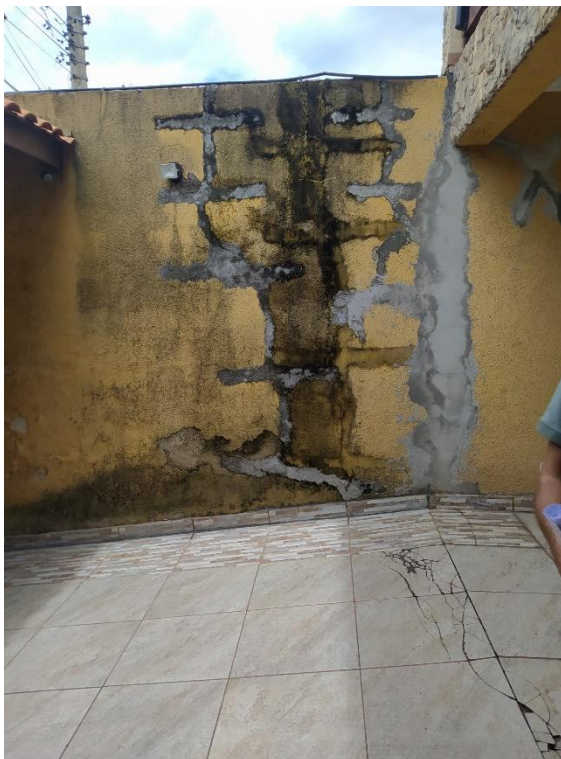
Figura 68: Reparos no imóvel nº 25 efetuados em períodos pretéritos (decorrente de obras da Sabesp) e trincas no piso – 16 de dezembro de 2021.
