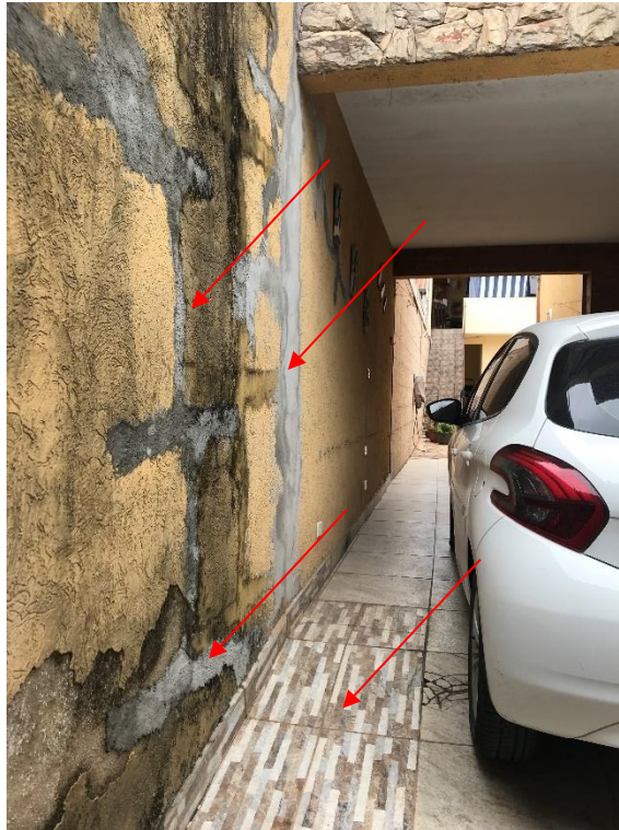
Figura 31: Reparos no imóvel nº 25 efetuados em períodos pretéritos – Decorrente de obras da Sabesp – 25 de outubro de 2021.
