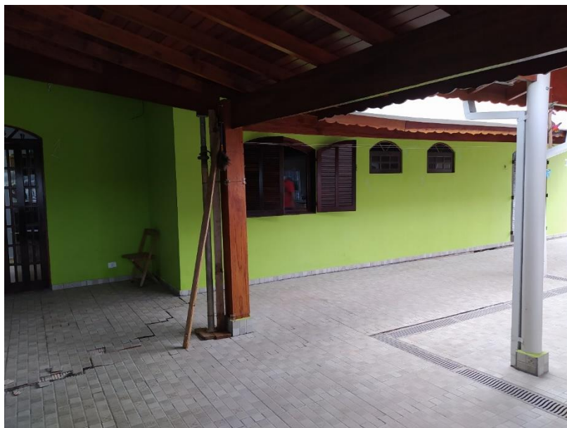
Figura 56: Trinca/Descolamento do piso na área do Imóvel nº 05 – 16 de dezembro de 2021.
