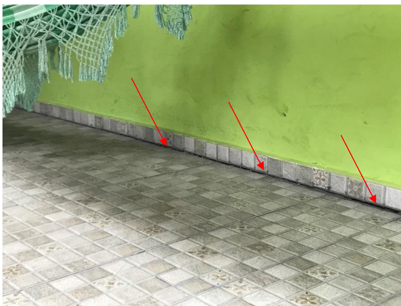
Figura 23: Descolamento/Trinca horizontal no piso junto a parede interna do imóvel vistoriado nº 05 – 25 de outubro de 2021.
