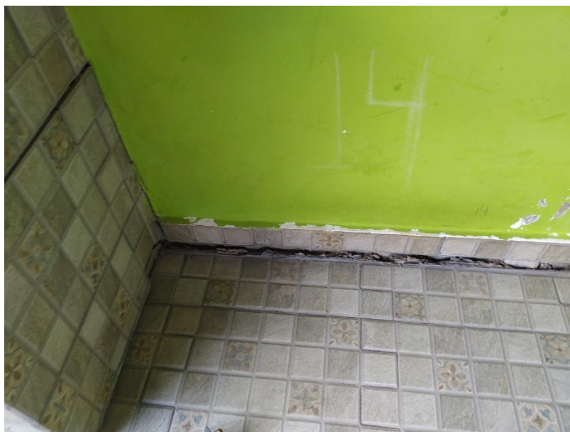
Figura 44: Trinca/Descolamento do piso na área do Imóvel nº 05 – 16 de dezembro de 2021.
