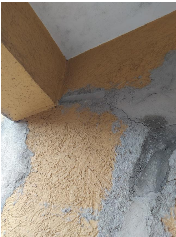
Figura 60: Reparos no imóvel nº 25 efetuados em períodos pretéritos – Decorrente de obras da Sabesp – 16 de dezembro de 2021.
