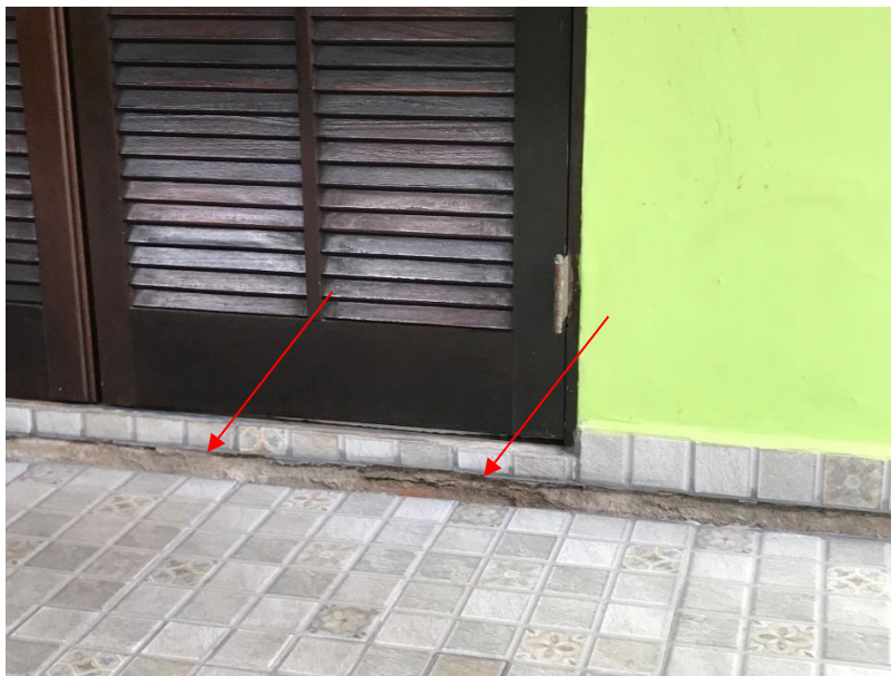
Figura 22: Descolamento/Trinca horizontal no piso junto a entrada interna do imóvel vistoriado nº 05 – 25 de outubro de 2021.
