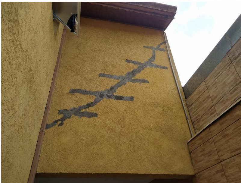
Figura 62: Reparos no imóvel nº 25 efetuados em períodos pretéritos – Decorrente de obras da Sabesp – 16 de dezembro de 2021.
