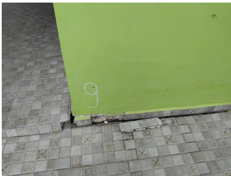
Figura 38: Trinca/Descolamento do piso na área do Imóvel nº 05 – 16 de dezembro de 2021.
