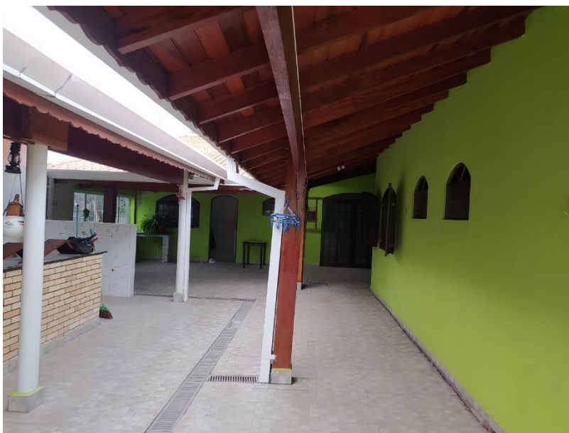
Figura 50: Trinca/Descolamento do piso na área do Imóvel nº 05 – 16 de dezembro de 2021.
