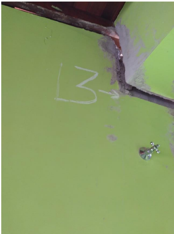
Figura 43: Trinca/Descolamento vertical junto ao muro de fechamento do imóvel nº 05 – 16 de dezembro de 2021.
