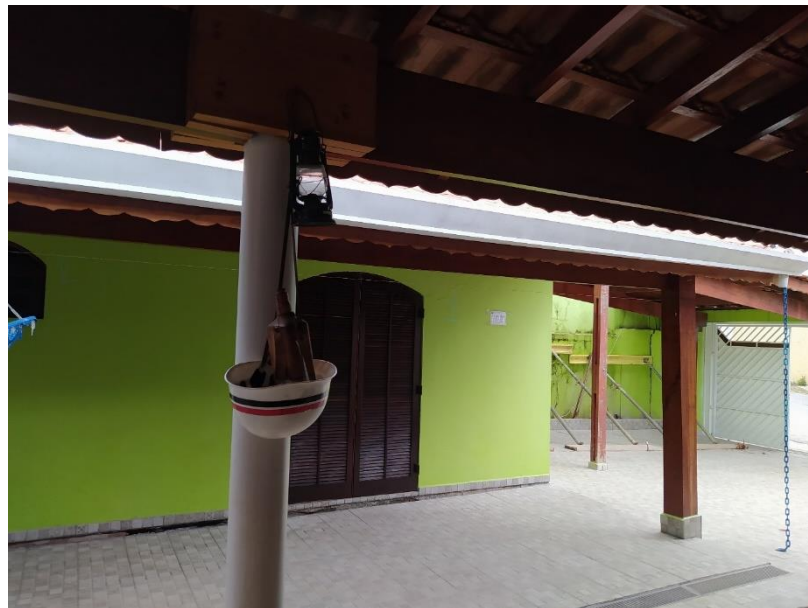
Figura 40: Trinca/Descolamento do piso na área do Imóvel nº 05 – 16 de dezembro de 2021.
